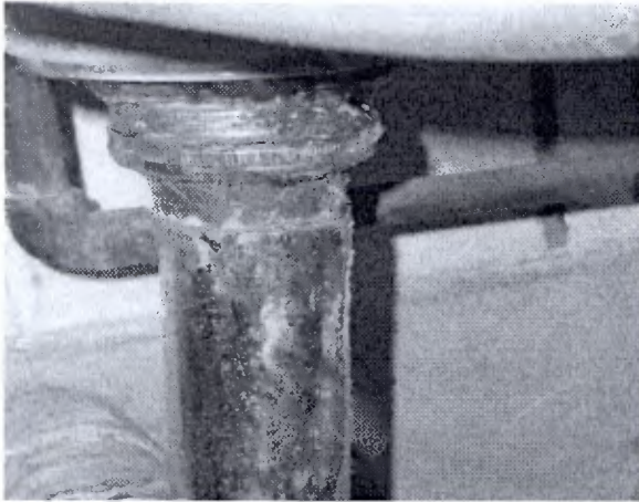
Cañería con filtraciones
